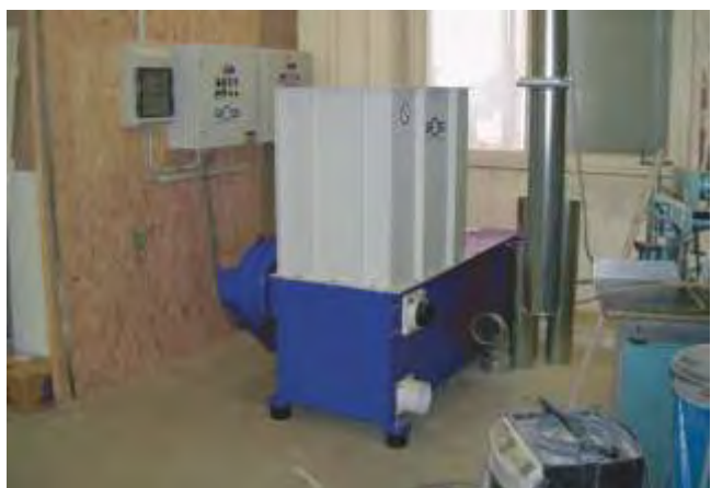
GAZ 62 Installation an eine Absaugung
